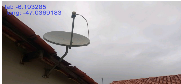
FOTO - ANTENA BANDA KU INSTALADA COM LNB
