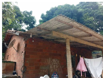
Foto - Antena Banda Ku instalada com LNB
