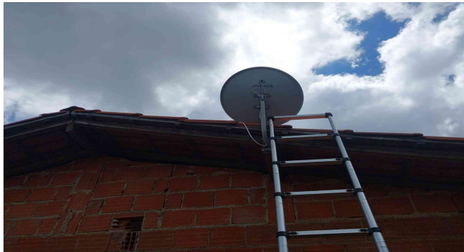
Foto – Antena Banda Ku Instalada
